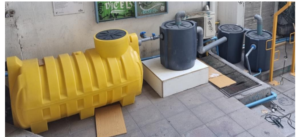
Fuente: Sistema de tratamiento aguas grises, imagen propia.
